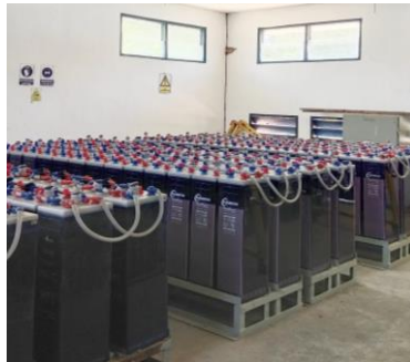
Gambar 4. Baterai PLTS Pulau Karanrang.
