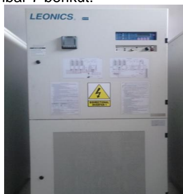
Gambar 5. Inverter PLTS Pulau Karanrang
