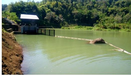
Gambar 3. Kondisi bangunan INTAKE PLTA Tangka
