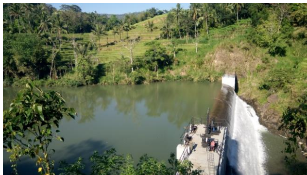
Gambar 2. Kondisi bangunan bendung PLTA Tangka
