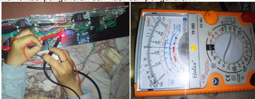
Gambar 20. Pengukuran Tegangan pada Relay
